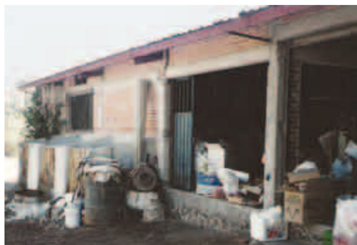
Instalaciones del CADST
