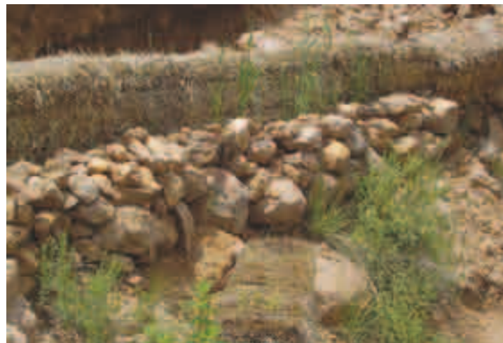
Barreras de protección
